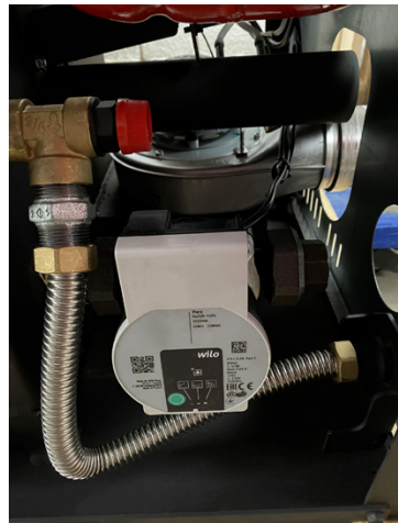
Sicherheitsventil und Ladepumpe
