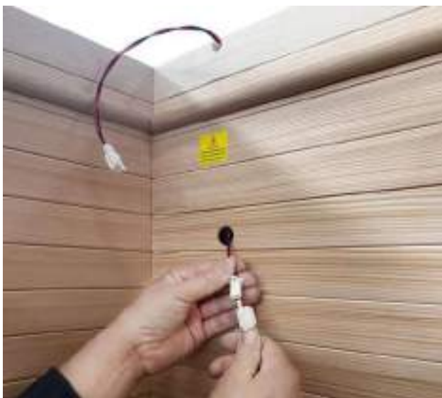
(9) Připojte kabel saunového světla podle výše.
